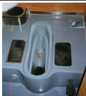
（図4）濁沢ヒュッテ便器
