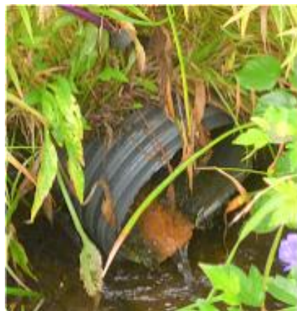
見晴の「切れた排管」2019/9/1
